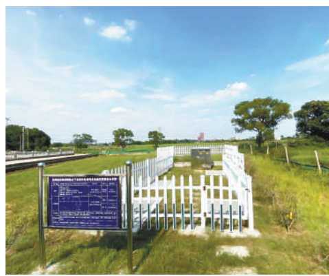
新建农村污水模块化SDN生物滤池实景图
