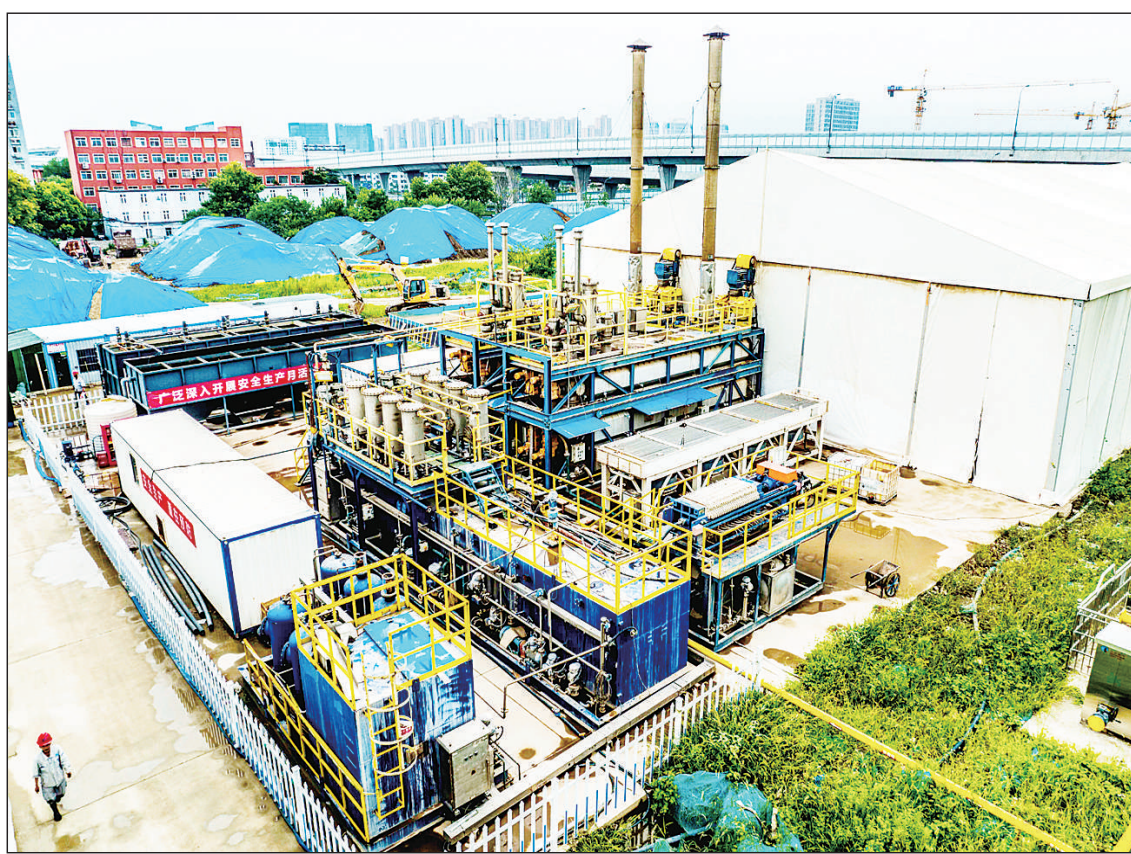
近年来,作为全国老工业区搬迁改造试点城区之一的安徽省合肥市瑶海区,多措并举对辖区内工业遗存土地的污染土壤进行治理修复,让污染地块获得“新生”,推进老工业区绿色转型发展。图为瑶海区原工业生产区域的污染土壤进行异位热脱附治理修复现场。
