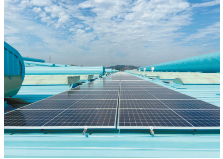
宝钢已建成的超大型屋顶光伏发电项目。
