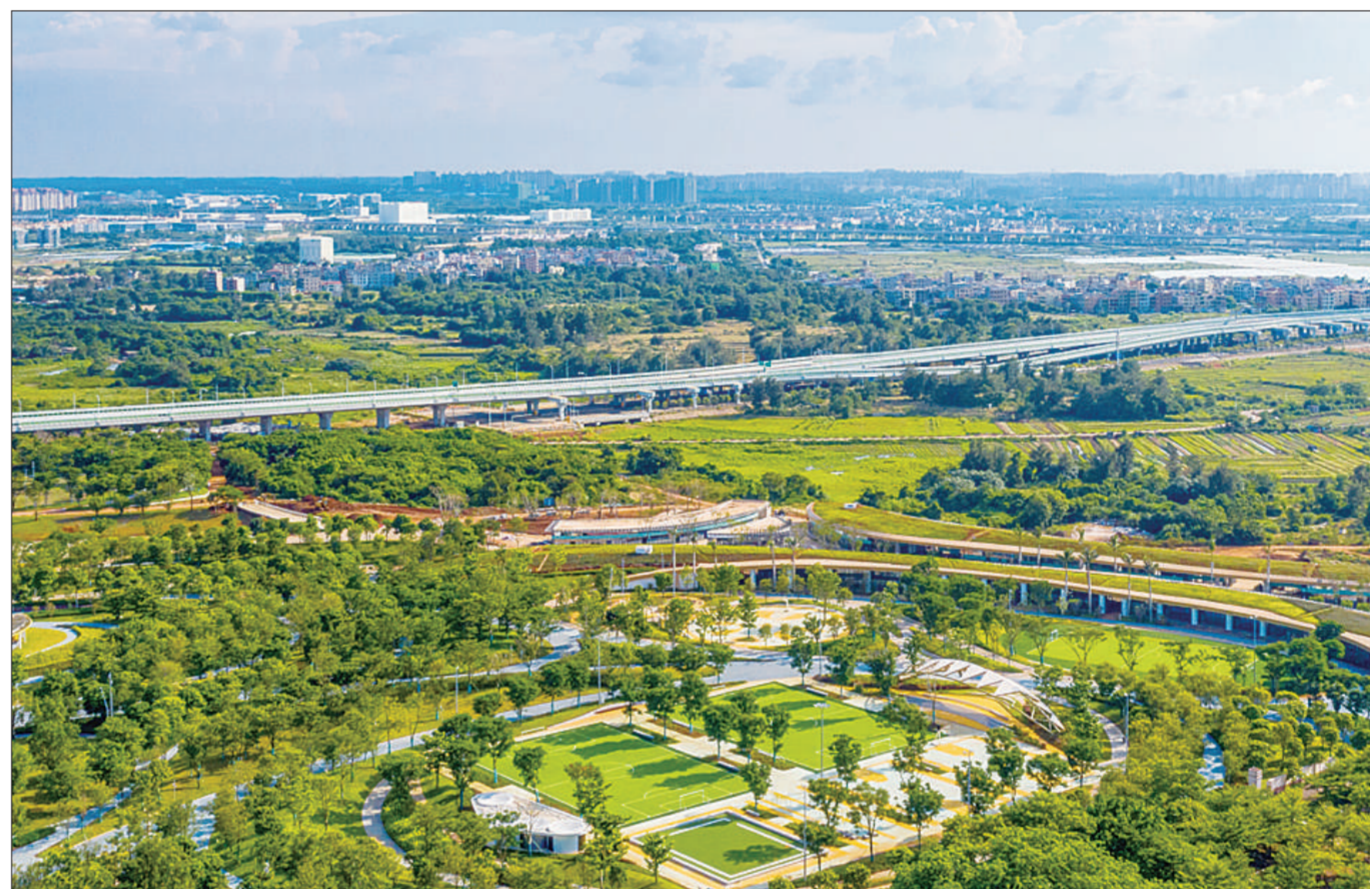
海南省海口市西海岸南片区生态修复工程近日正在加紧施工。据了解,西海岸南片区生态修复工程总体规划面积约1118.85亩,将海口精神文化底蕴与地域特色融合,打造集河、洲、林、巢四大核心景观于一体的复合型生态地标级综合公园,满足更多市民休闲需求,进一步提升海口西海岸城市形象。 人民图片网供图
