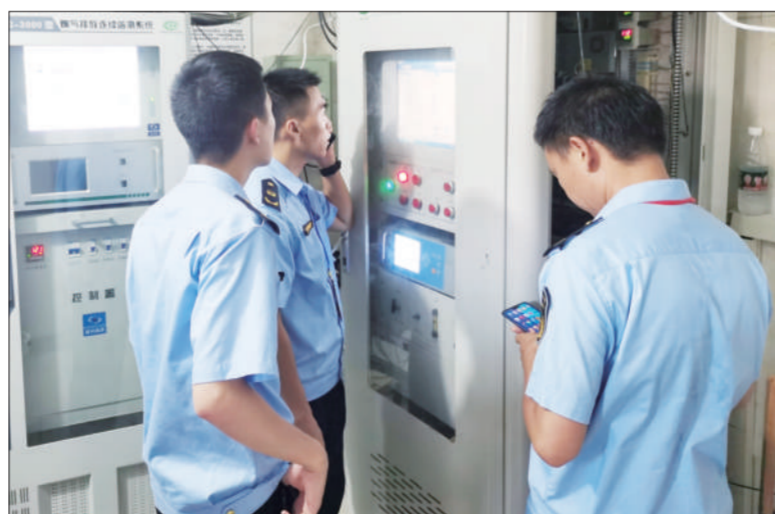
执法人员现场查看某公司自动监控设施运行情况。 江西省生态环境厅执法局供图
