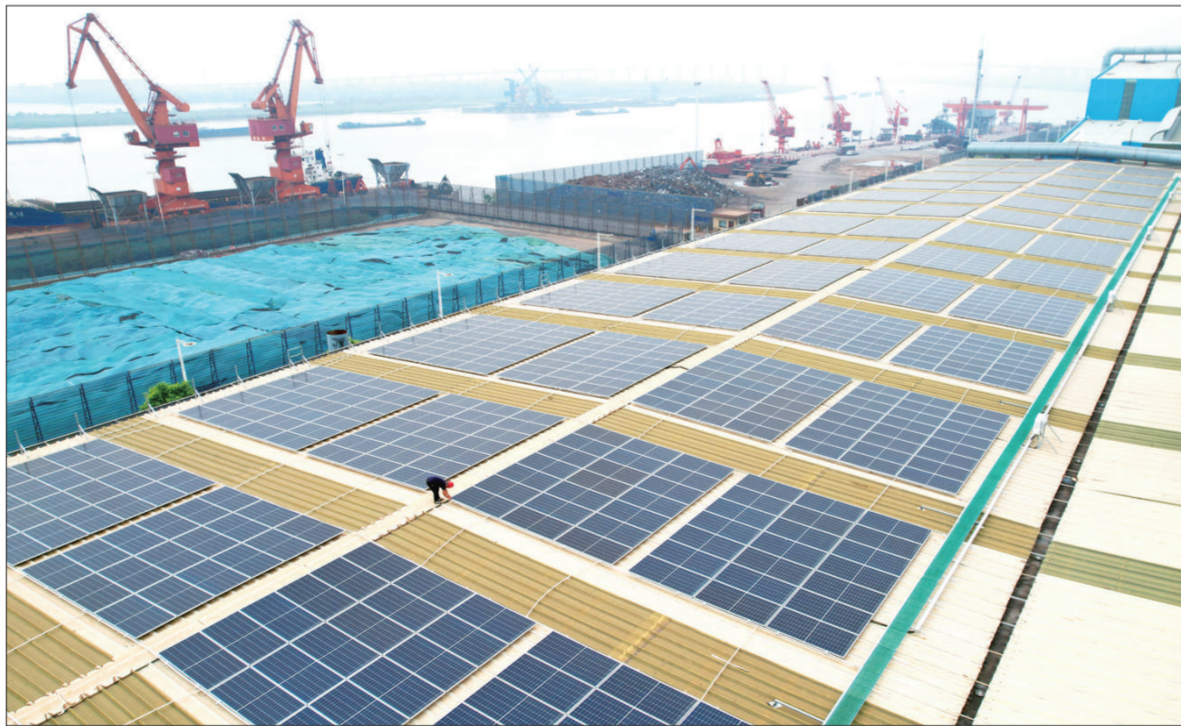
江苏省连云港市首个“光伏+钢铁”分布式光伏发电项目近期在连云港亚新钢铁有限公司建成投运,并网发电。项目采用“自发自用,余电上网”模式,就近接入低压配电房,企业可以享受自家屋顶上的绿色能源。图为工作人员在进行光伏组件投运前的最后巡视和检查。
