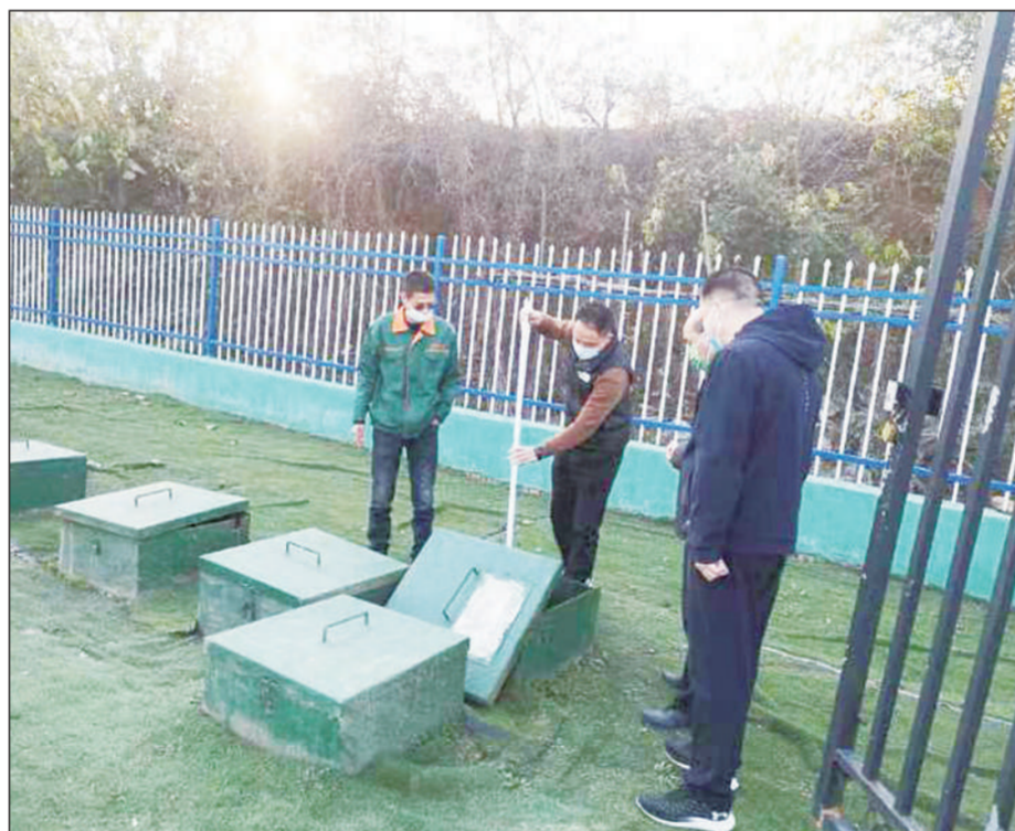
今年以来,河北省邯郸市丛台区投入资金约3.3亿元,在55个村共铺设约60万米污水管网、建设45座一体化污水处理站及14座中转换提升泵站,实现农村生活污水治理全覆盖。图为工作人员检查处理后的出水水质情况。 蒿文祥摄
