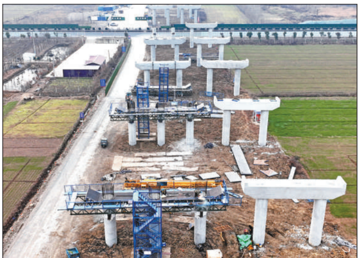
12月29日,工人在连宿高速公路连云港段仲集互通工程加紧施工。连云港至宿迁高速公路是《江苏省高速公路网规划(2017—2035年)》“十五射六纵十横”中“横三线”重要组成部分,建成后连云港至宿迁最快只需1个小时10分钟,对落实淮河生态经济带战略、提升陆桥国家综合交通运输大通道能力、促进沿线城镇化和产业园区开发等具有重要意义。 人民图片网供图
