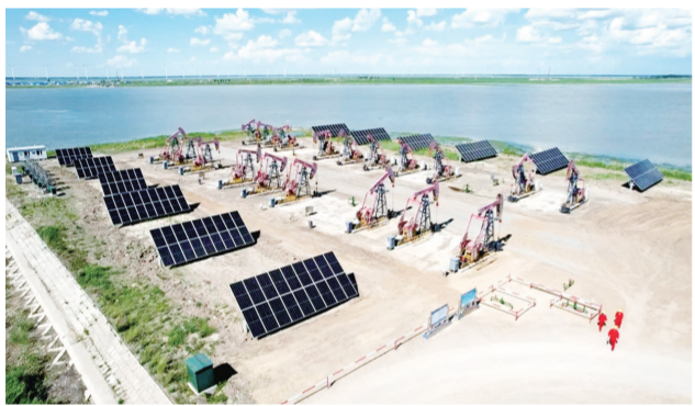
图为葡47区块微光伏发电先导试验工程。
