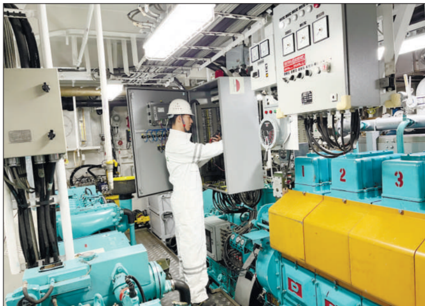
图为1月16日,电机员崔兴正在开展主机遥控系统的检查、测试。
