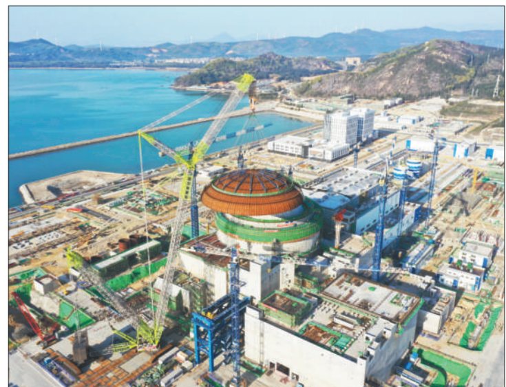
我国自主三代核电华龙一号批量建设首台机组——中核集团漳州核电1号机组外穹顶近日成功吊装,标志着该机组主体结构工程施工完成,为后续安装冷试及并网发电奠定坚实基础,华龙一号批量建设迈出坚实步伐。中核集团供图
