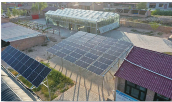
▲图为地热+PVT热电冷清洁三联供项目。中核集团供图
