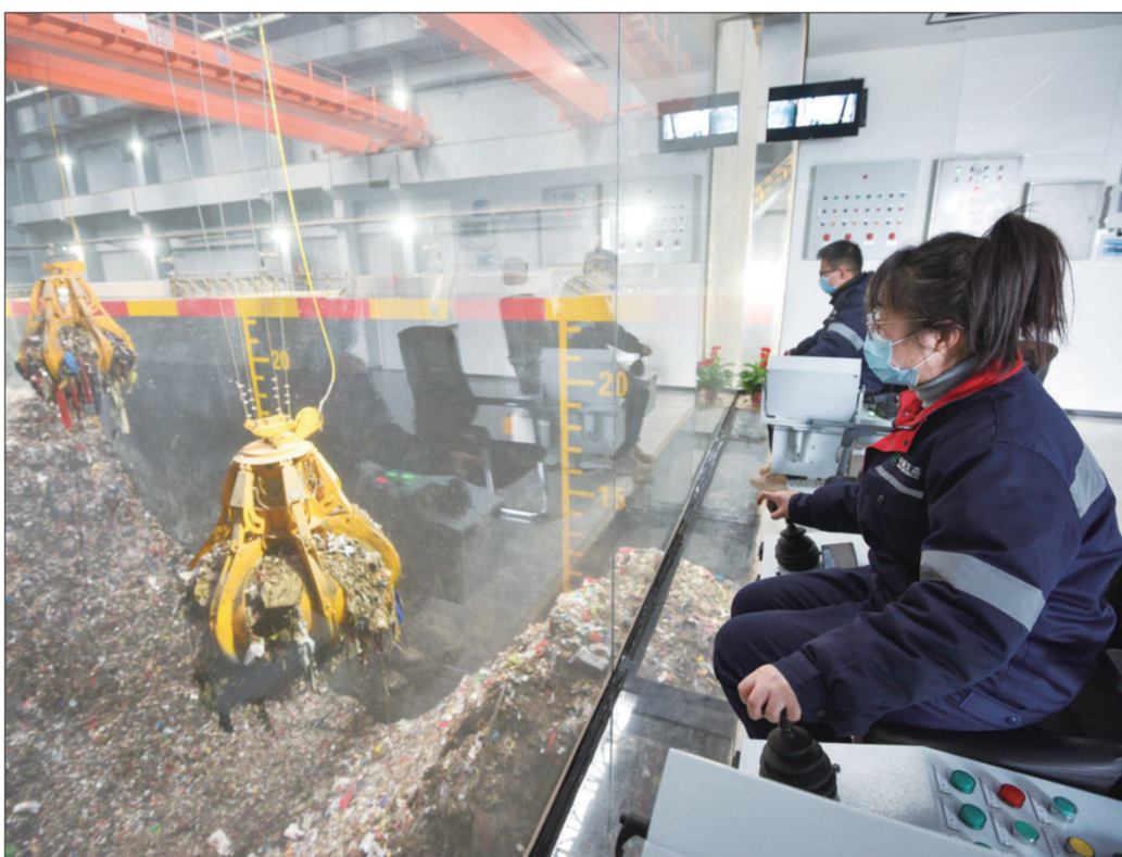
在山西省运城市生活垃圾焚烧发电厂项目车间内,工作人员在用机械爪处理垃圾仓内的生活垃圾。
