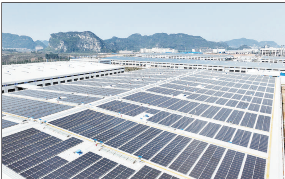
近日,广西壮族自治区柳州市柳江区新兴工业园柳州津晶一期1号6.5MW分布式光伏项目并网发电,助力园区企业绿色环保低碳转型发展。据了解,这一项目采用屋顶光伏建设模式,总安装面积约33万平方米,可装光伏容量约40兆瓦,形成“全额上网”的发电模式,将成为广西单体最大的分布式光伏电站。 人民图片网供图
