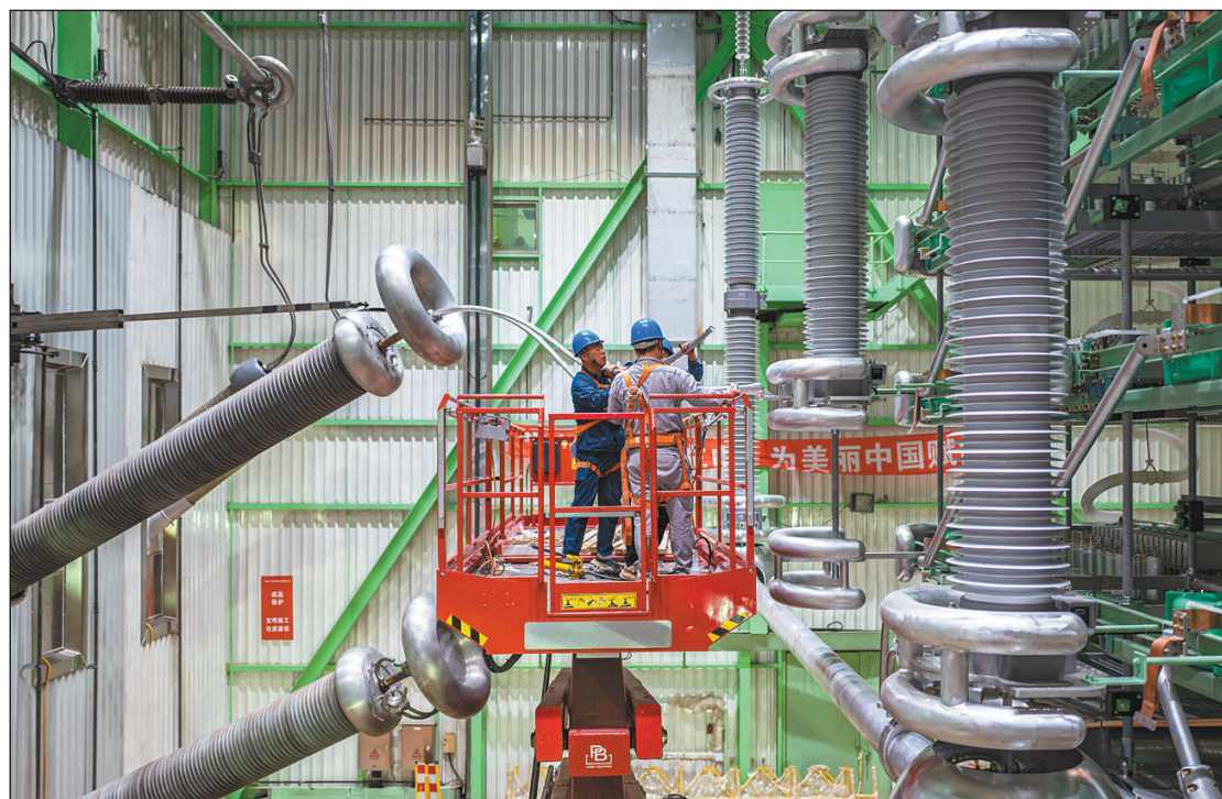
4月11日,我国首座500千伏直流换流站——上海南桥换流站综合改造工程完成设备安装,进入系统调试阶段。葛洲坝至上海南桥直流输电工程是我国首条±500千伏直流输电线路,自1989年投运以来一直是外电入沪的重要枢纽,源源不断地将来自葛洲坝电站的清洁水电送入上海电网。此次改造的核心是完成组件国产化替代,进一步提升运行可靠性,推动电网低碳化、绿色化转型升级。
