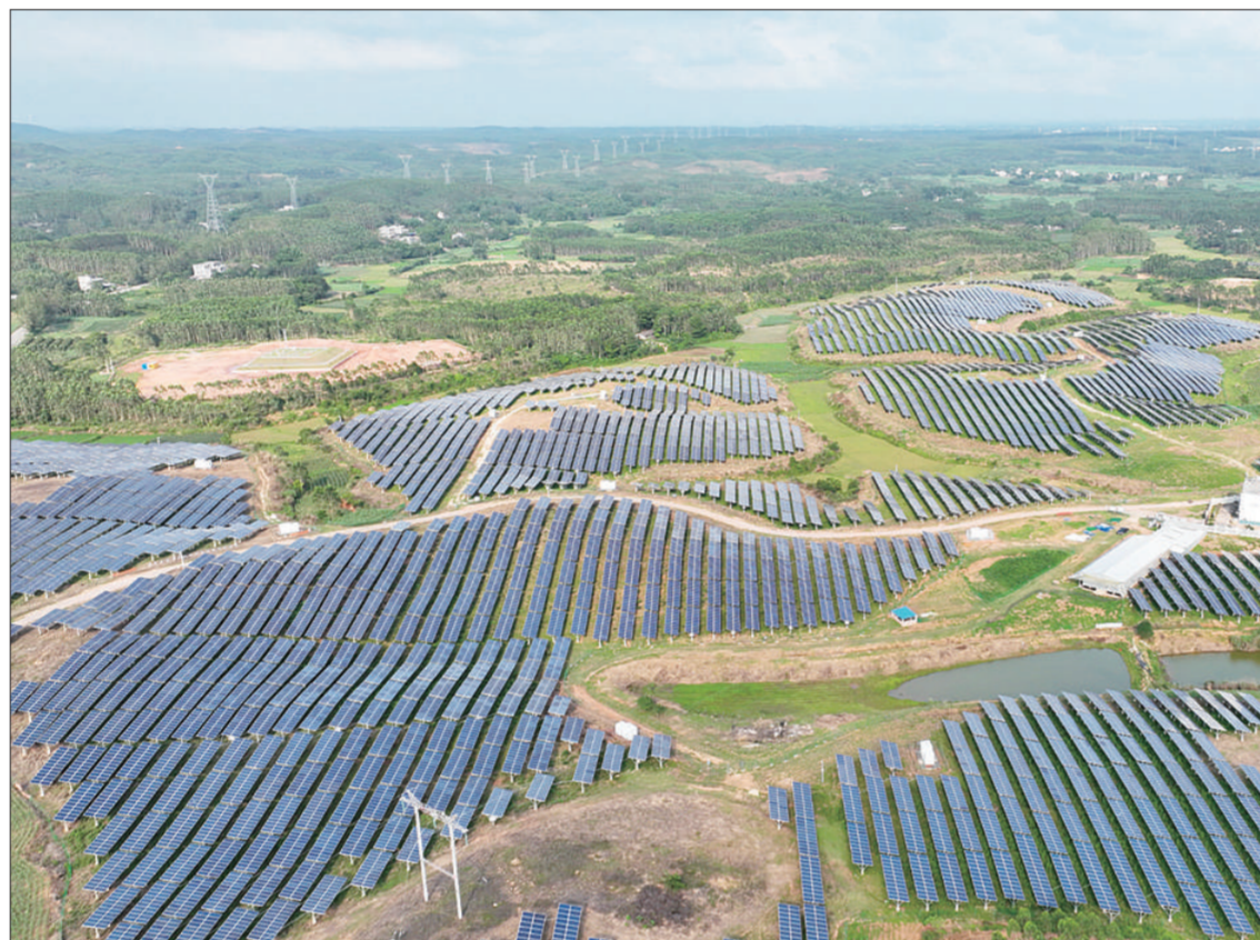
近年来,广西壮族自治区合浦县大力发展光伏产业,壮大村集体经济,有效助力乡村振兴。图为合浦县星岛湖镇光伏电站农业养殖示范基地。
