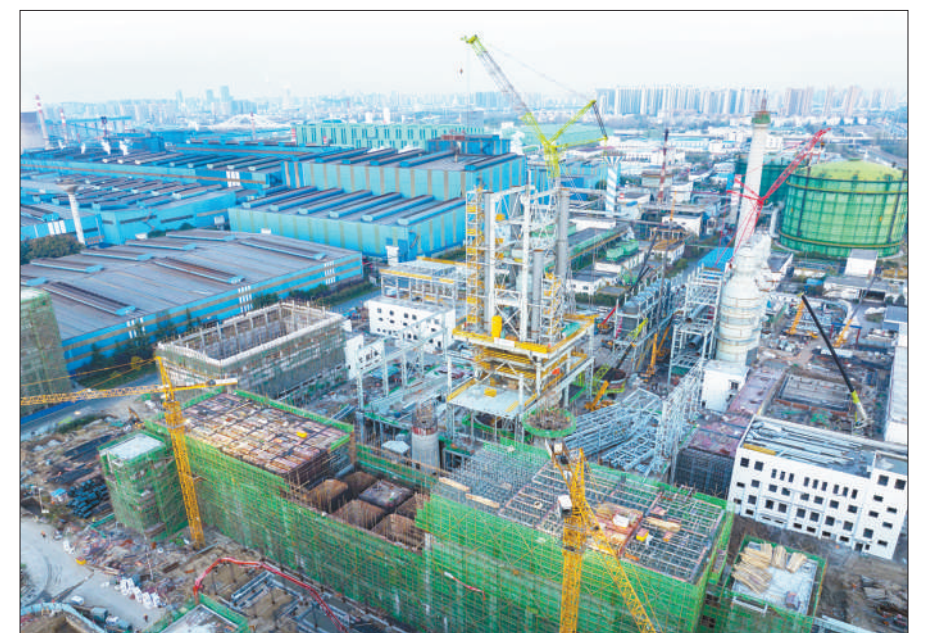
近日,江苏沙钢集团淮钢特钢股份有限公司高炉绿色低碳升级改造工地上施工作业。公司通过高炉、电炉绿色节能升级改造,助力产品结构优化和品质提升,增强市场竞争力和品牌效益。
