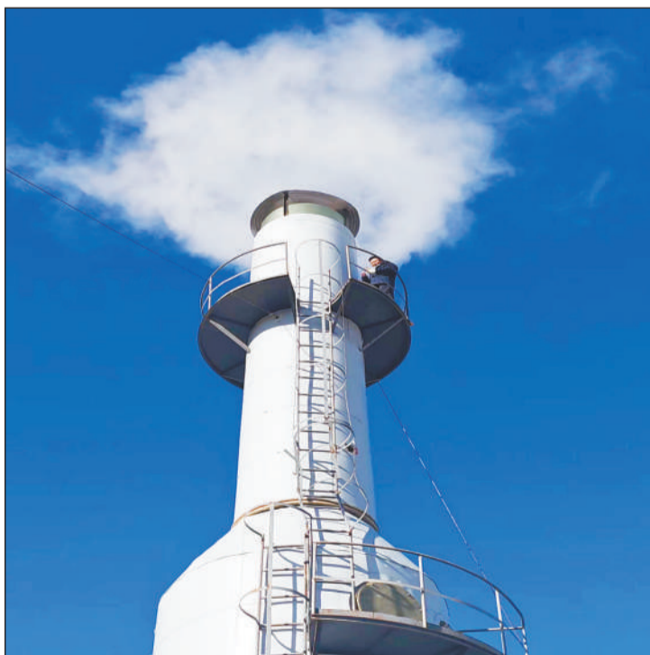
为进一步提高污染源执法监测数据质量,全力做好供暖季大气污染防治工作,近日,河北省石家庄市生态环境局冀城分局全面启动供暖锅炉专项执法检查,执法人员采取“非现场”检查与现场实地监测相结合的方式,对排污单位锅炉废气排放口进行不定期监督监测,确保达标排放。图为监测人员进行现场监测。 张铭贤 胡振伟摄
