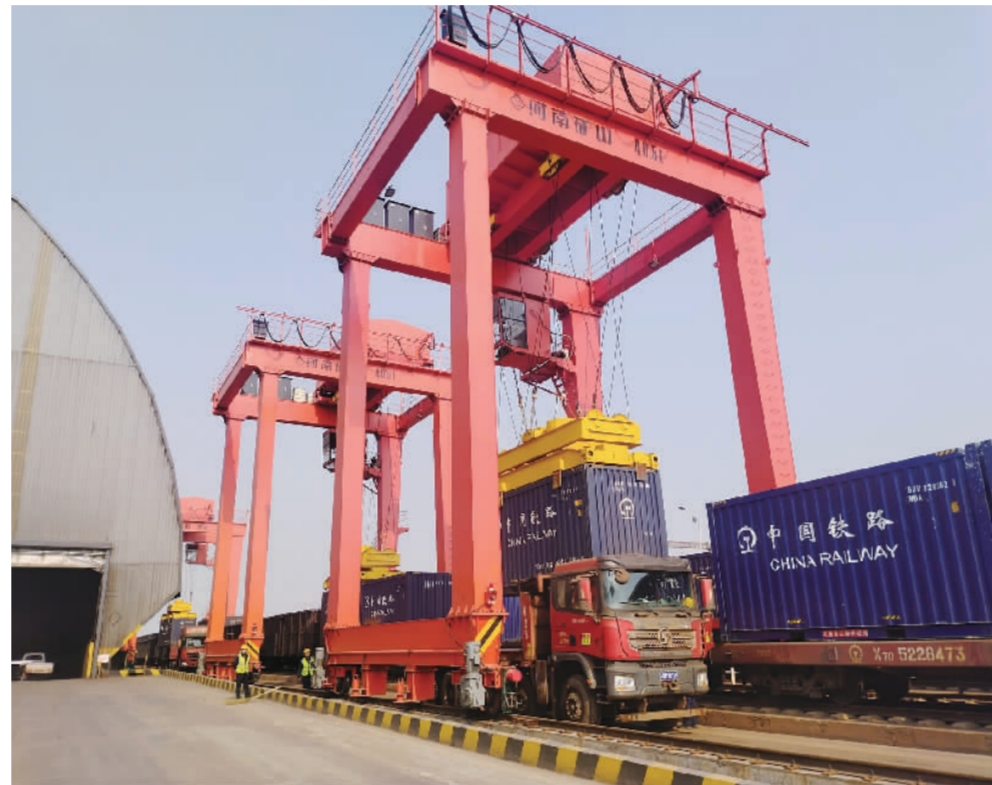
近日,一列装载3500吨铁矿石的“公转铁”生产物资配送专列,驶入山东省潍坊东站,正在卸车。今年以来,国铁济南局通过改造提升铁路专用线,增设龙门吊和调车机等一系列方式,为厂家构建了从原材料进厂到产成品出厂的铁路全物流链条,打通“公转铁”运输的最后一公里。
