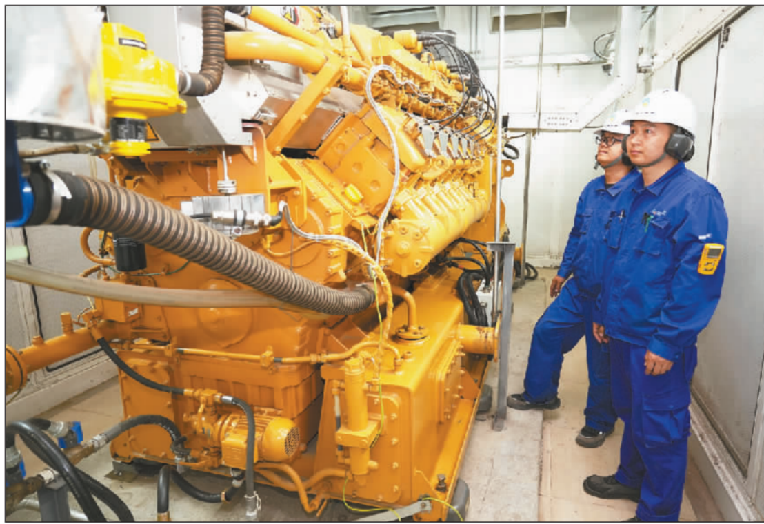
高碑店再生水厂沼气热电联产项目是北京市重点可再生能源发电项目,总装机容量6.4兆瓦。再生水厂的污泥通过水解和高级厌氧消化处理,每年可产沼气超2000万立方米。沼气可通过热电联产,实现“热”“电”两种能源的回收利用。热能高效回收发电产生余热,用于污泥热水解工艺用热及全厂建筑采暖,有效实现清洁能源替代。
